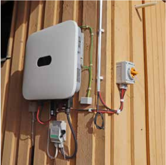
Aurinkosähköjärjestelmän äly piilee vaihtosuuntaajassa.
