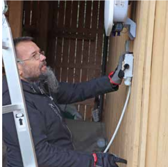
Invertterin asennus sujui sähköasentaja Jari Kataralta jo rutiinilla.
